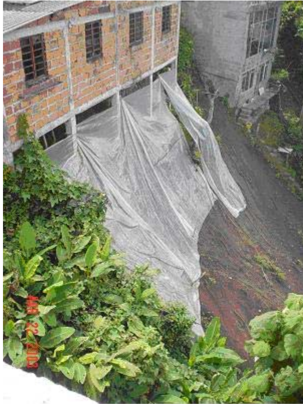
Figura 3. Las viviendas en la corona de laderas carentes de estructuras para el manejo de aguas de escorrentía, son los factores detonantes de procesos de inestabilidad.
